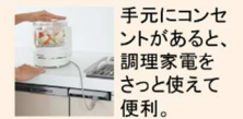
シンク下ユニットのコンセント。水がれからコンセントを守る形状。
